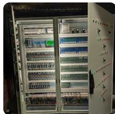
Armoires CVC du bâtiment Tazenat
